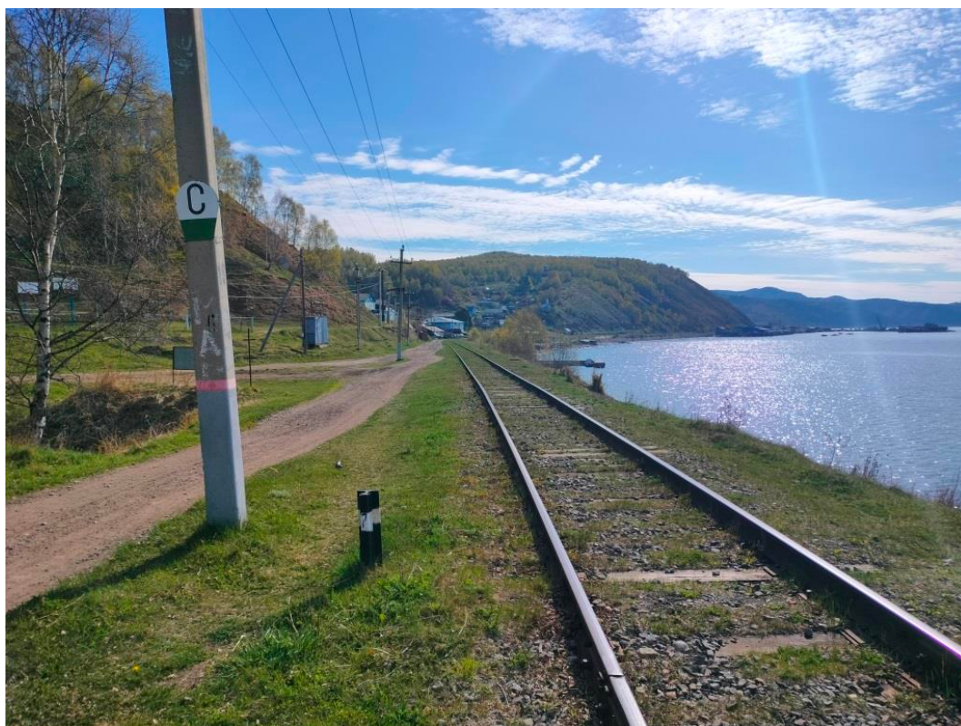
Рисунок Е.9 – Переход КВЛ 10 кВ через р. Щелка
